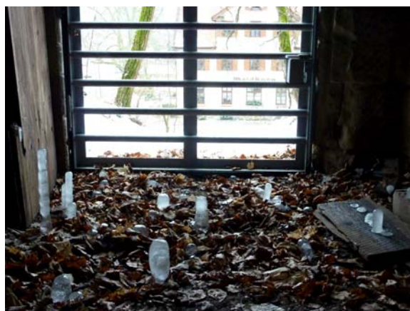
Abb. 5: Im Eingangsbereich können sich beim Wechsel zwischen Tau- und Frostwetter durch von der Decke tropfendes Wasser Eisstalagmiten bilden. Bild: E. Müller
