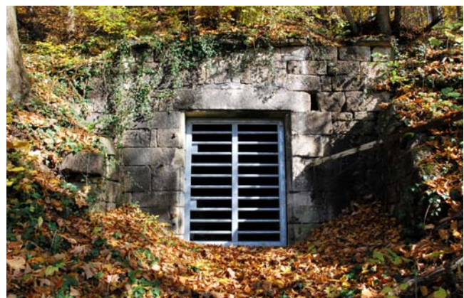
Abb. 2, 3: Der Einbau des ca. 150 kg schweren Tores bedeutete Schwerstarbeit für die ehrenamtlichen Fledermausschützer. Der Abstand zwischen den horizontal verlaufenden Rohren ist so groß, dass zwar Fledermäuse problemlos durchfliegen, aber Kinder nicht den Kopf hindurch stecken können. Bilder: E. Müller
